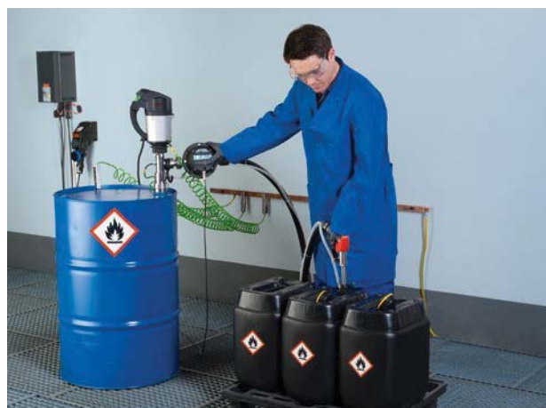
Полуавтоматическое наполнение резервуаров во взрывоопасной зоне 1
